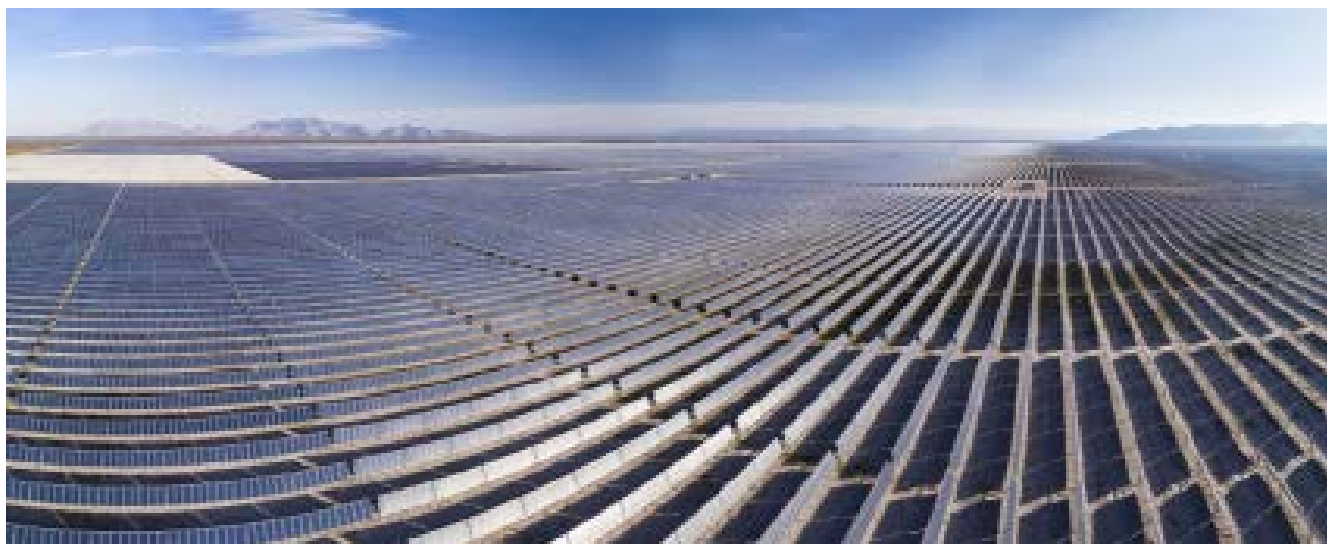
Imagen 1. Planta Solar Villanueva
